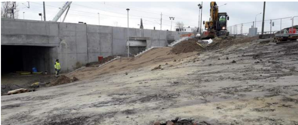
Figur 8: Anläggande av trappor och gång- och cykelväg under järnvägen vid Burlövs station. Foto Ragnhild Karlsson.
